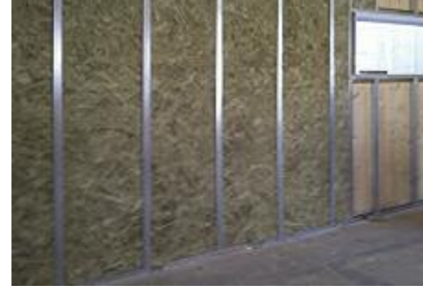
A destra, due immagini della posa della controparete interna al piano terra.
